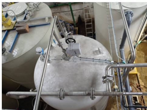
Reakce ozonu s léčivý a oxidovatelnými látkami v odpadní vodě po biologickém čištění probíhá v tomto nerezovém reaktoru s vnitřní vestavbou (samozřejmě také z nerez).
