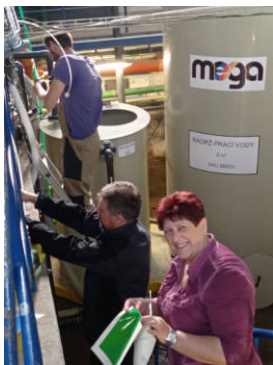
Projektanti DVH labelují instalovanou technologii – Magdalena Havlová, Jakub Kučera, Václav Kubiček.
