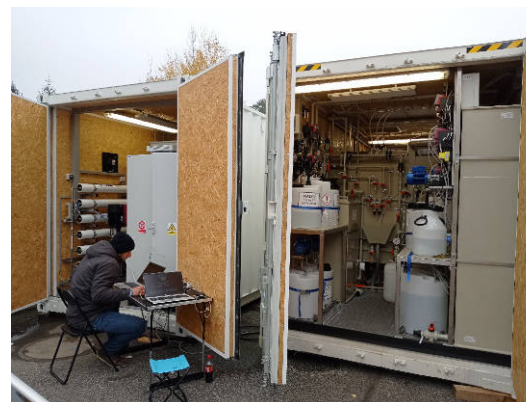
Kontejner 1 (předúprava) a kontejner 2 (NF+RO) ve Stráži v přípravné fázi programování ŘS
